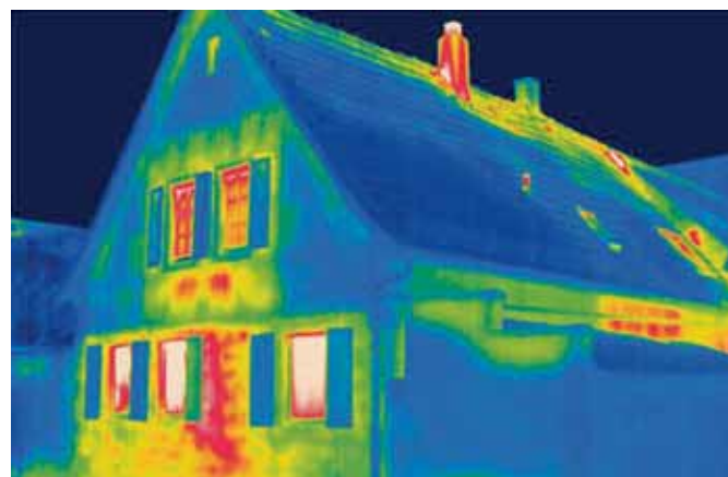
Die Aufnahmen einer Wärmebildkamera machen deutlich, wo die Gebäudehülle Schwachstellen hat
